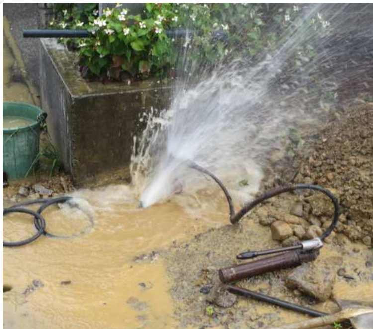
管路の老朽化による漏水の発生
