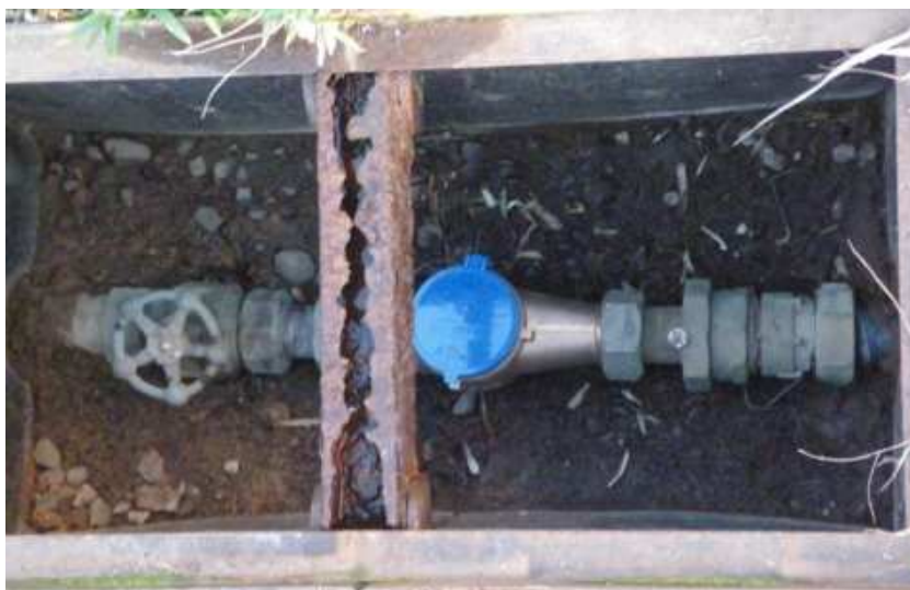
メーター周りの給水管の様子
