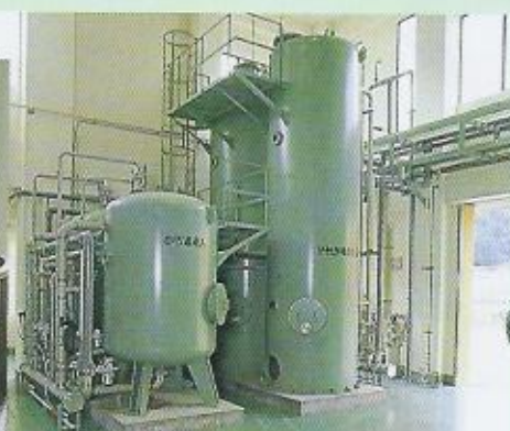
砂ろ過塔・活性炭塔
