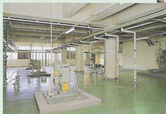
◀生物処理槽上部 (ばっ気機・攪拌機)
