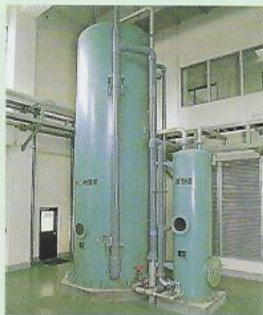
◀オゾン処理塔
