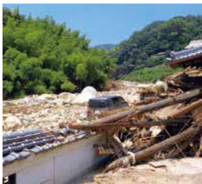
がれきなどが作業の妨げに（広島県呉市）
