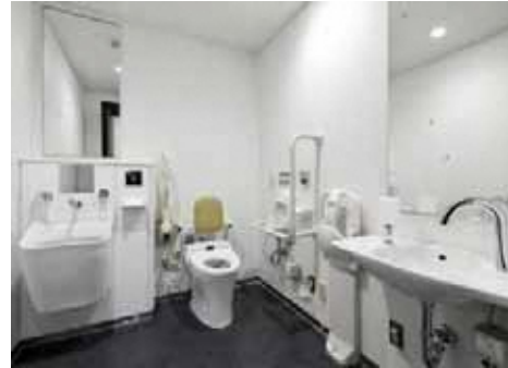
多目的トイレの例
