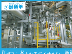
排ガスに含まれるダイオキシン類等を取り除く。
