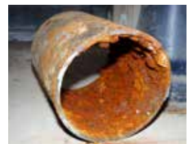
老朽化した水道管
