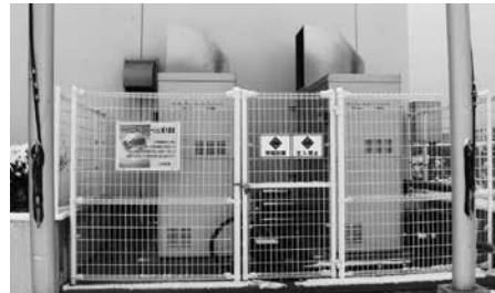
秋田県のメタンガス利用発電施設
