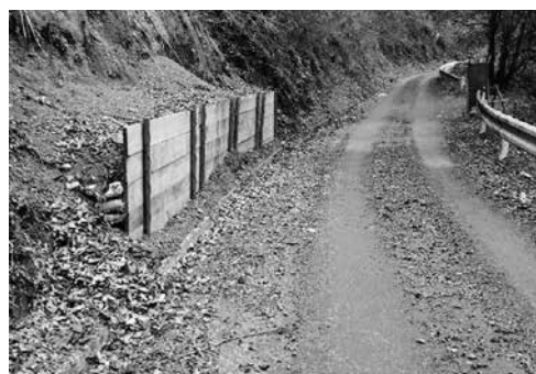
対策が望まれる市道雲見線
