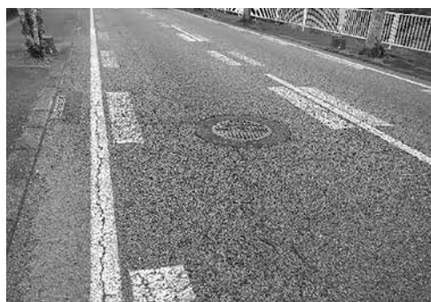
振動の原因？ 損傷が激しいマンホール周辺
