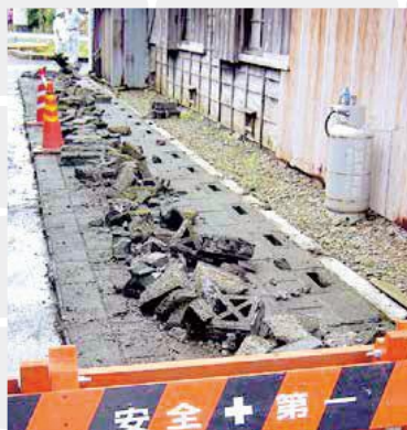
倒壊したブロック塀
