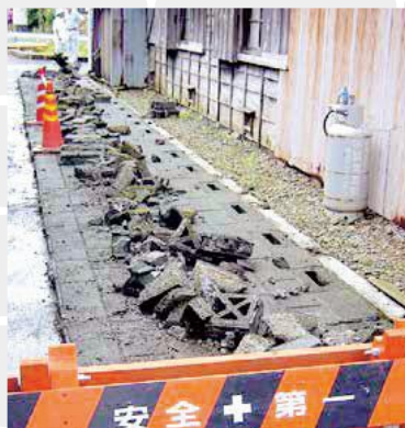
倒壊したブロック塀
