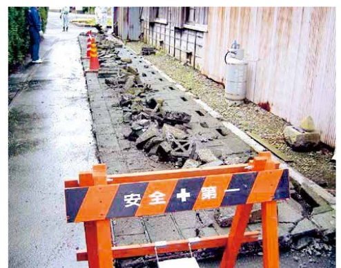
倒壊したブロック塀(提供:静岡県)
