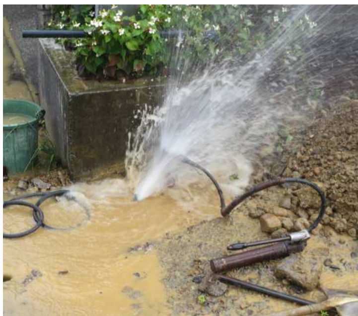
管路の老朽化による漏水の発生
