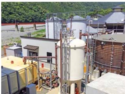
川根温泉のメタンガス発電システム
