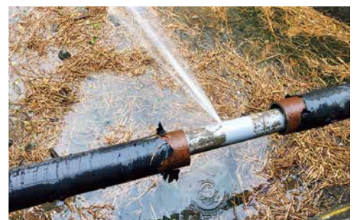
破損した水道管の一部(破損箇所から水が吹き出している)
