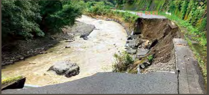
伊久美川の増水により、崩落した県道蔵田島田線
