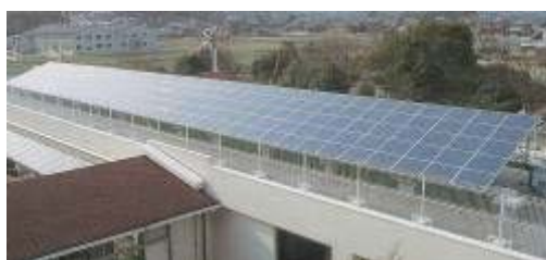
太陽光発電設備（20kw）
