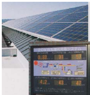
太陽光発電設備（20kw）
