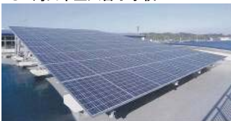
太陽光発電設備（20kw）
