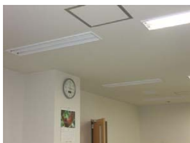
蛍光灯を間引きしています。
