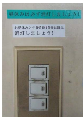
印刷室などの共用スペースは、節電対策として、昼休み・定時以降に電源を切っています。
