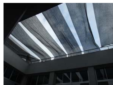
中庭上部や窓に寒冷紗の日よけを設置し、エアコン効率を上げています。(本庁舎)
