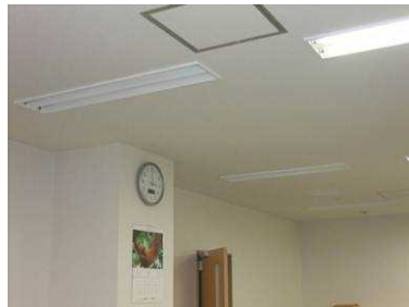
蛍光灯を間引きしています。
