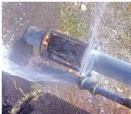
破損した水道管
