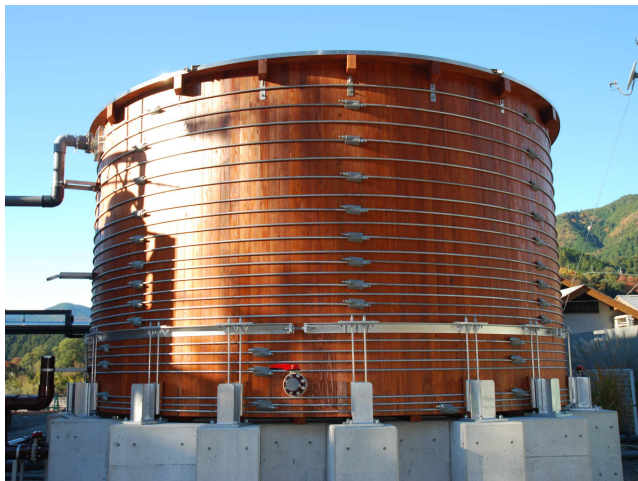
写真 1-1-2 木製貯湯タンク(川根温泉)
