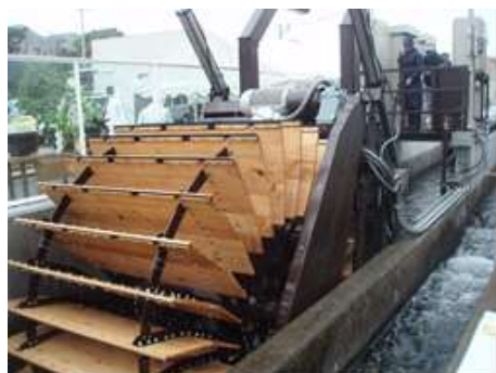
水車式発電機（8kW）
