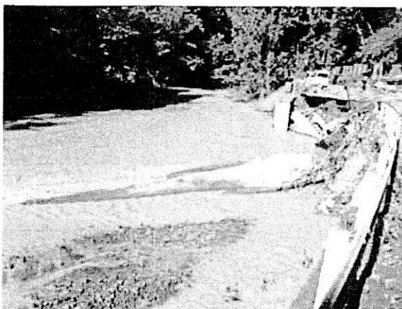
流出した林道市井平橋
