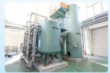
砂ろ過塔・活性炭吸着塔
