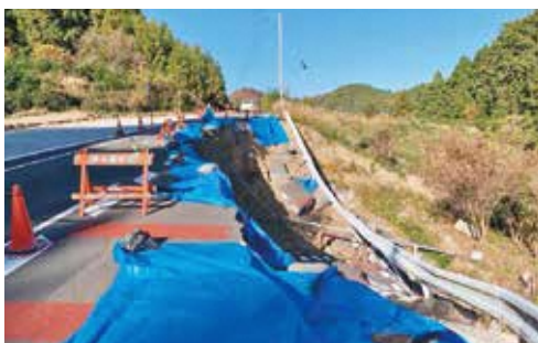
尾川上伊太線の地滑り現場
