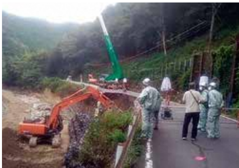
決壊した伊久美地区の県道
