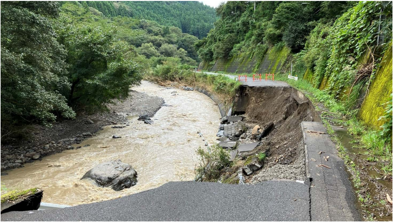
県道蔵田島田線 島田市伊久美地内（二俣地区） 9月25日 16時頃
