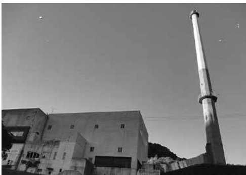
老朽化による災害が起こる前に解体実行を
