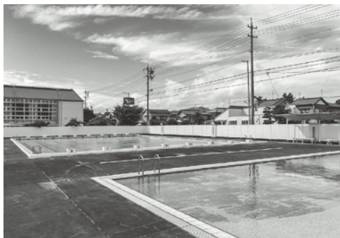
老朽化が進む小・中学校のプール
