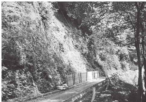
対策が望まれる市道雲見線
