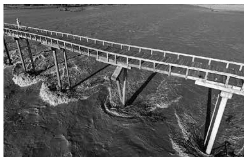
台風24号で破損した蓬萊橋修理へ
