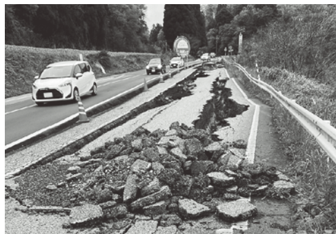
復興を妨げる被災道路（石川県穴水町）
