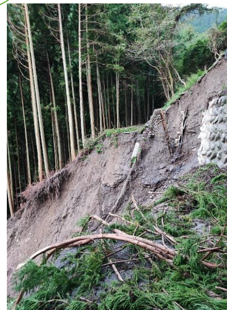
(災害により崩落した林道)
