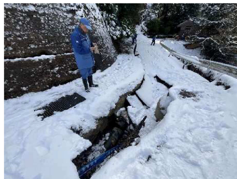
輪島市 送水管損傷
