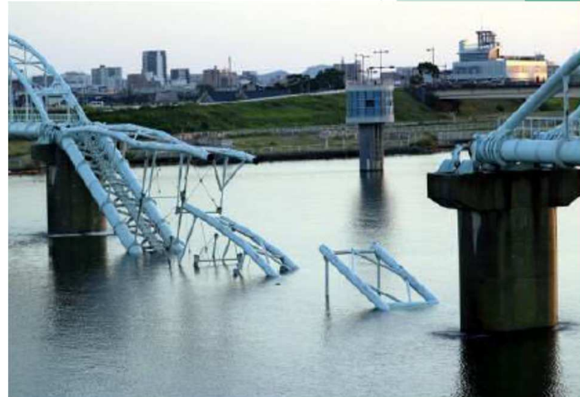
写真2 老朽化(腐食)による水管橋落下 鋼管 口径900mm
