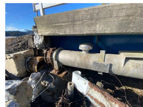
珠洲市 水管橋損傷
