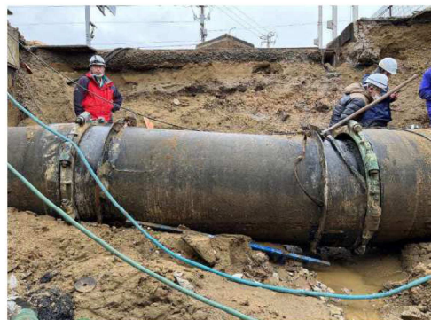
七尾市 送水管損傷
