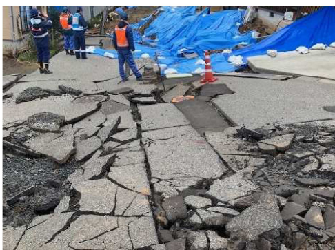
能登町 水道管損傷
