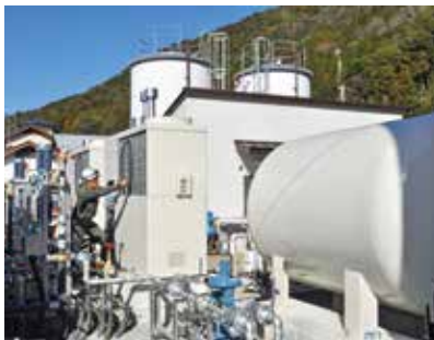
メタンガス発電施設
