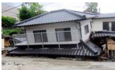
熊本地震で1階が倒壊した住宅
