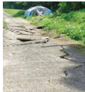
大きな亀裂が生じた道路 (熊本地震)
