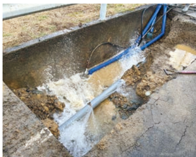
経年劣化によって漏水した水道管
